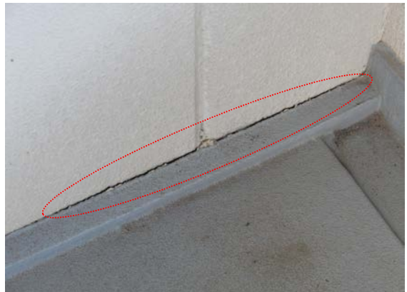
ALCジョイント：クラックより雨水侵入 塗膜劣化 漏水確認
