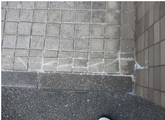
外構床タイル： ひび割れ発生
