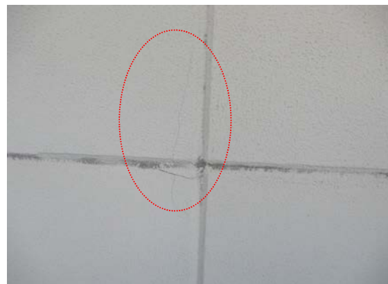
廊下ALC目地： 建物動きによるひび割れ発生
