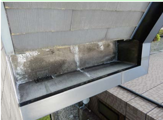
エントランスコロニアル屋根： 立上りアスファルト露出防水よりエフロレッセンス流出
