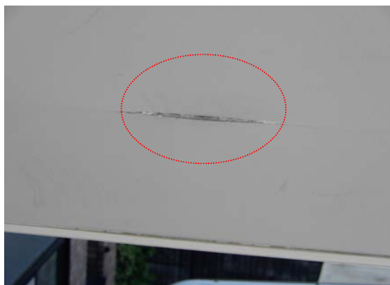
廊下天井： 天井ボードジョイントがずれています
