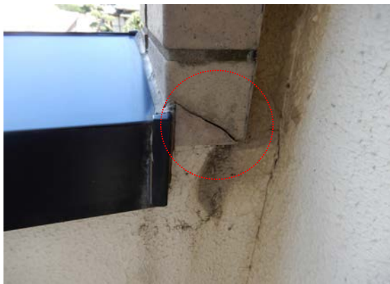
廊下塗装面：クラックより雨水侵入 塗膜劣化・錆汁流出
