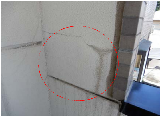
外壁塗装面：外部タイル面より雨水侵入 塗膜劣化・剥がれ
