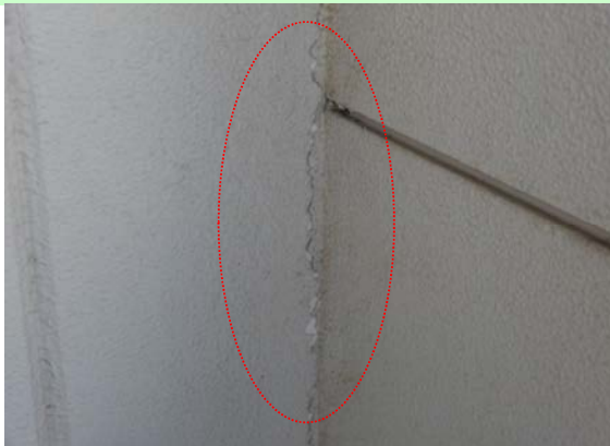
階段ALC モルタル入り隅： 動きによるひび割れ発生
