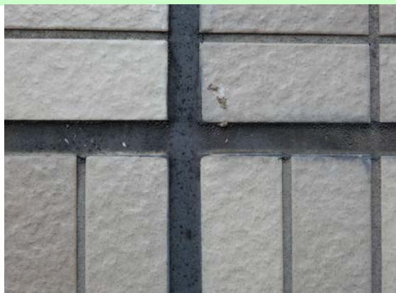
タイル伸縮目地シール： 経年劣化 シール機能低下
