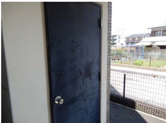
鋼製扉廻り: 塗膜劣化・チョーキング*
