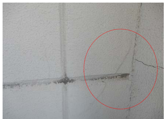
タイル面：クラックより雨水侵入 内部ひび割れ発錆
