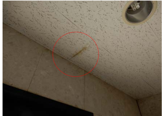
廊下天井ボード部： 外部より雨水侵入 内部鉄筋の錆汁流出
