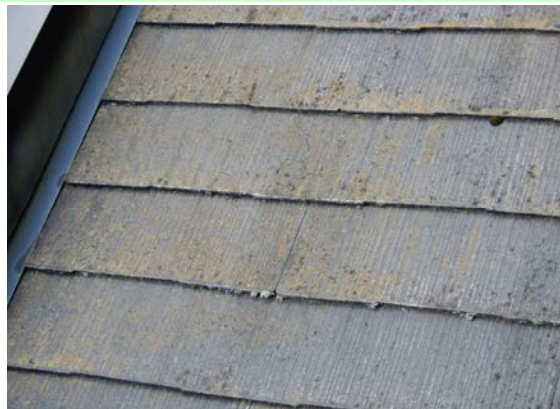
外壁塗装面：上部階より雨水侵入 塗膜劣化・剥がれ
