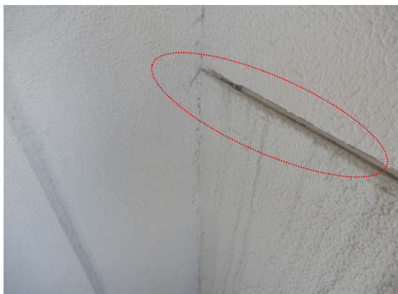
階段室ALCジョイント目地： 外部タイルシール目地より雨水が浸入しています
