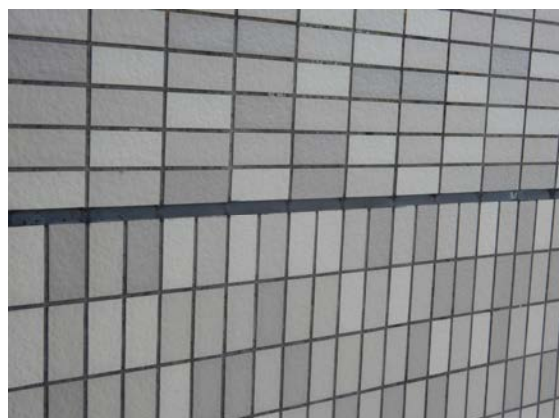
外壁目地：取合い目地 劣化 汚れ
