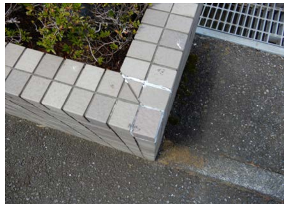
外構タイル： エントランス通路侵入通路 ひび割れ発生
