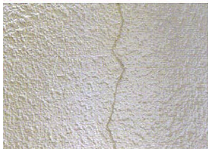
■ ひび割れ発生
